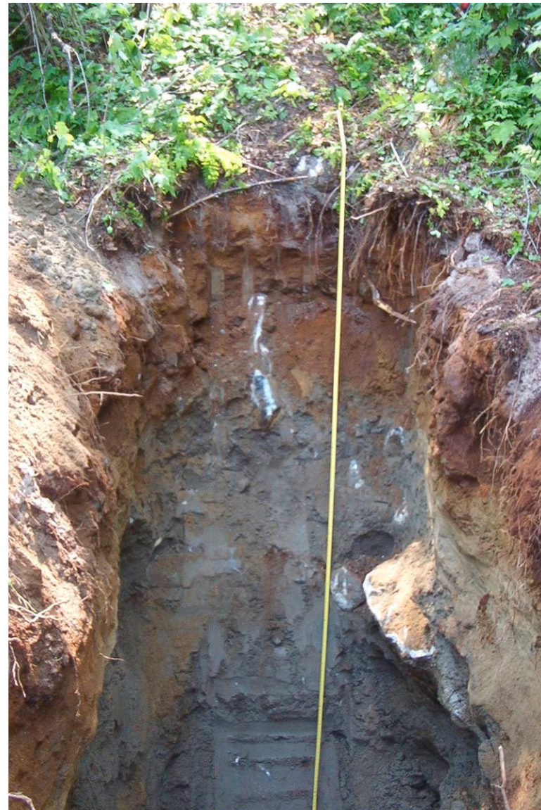
Photo 3.19 Chaînage 2200+525, au droit de la ligne de centre (vue vers le sud)
